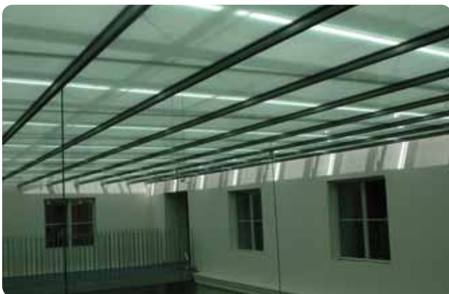
Obr. 4 Moravská galerie Brno používá KNX technologii od roku 2001 pro účely řízení osvětlení vč. vytváření světelných scén, řízení venkovních a vnitřních rolet ve vazbě na povětrnostní podmínky a vizualizace na PC
